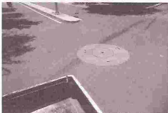
28. Pozos de aguas servidas
