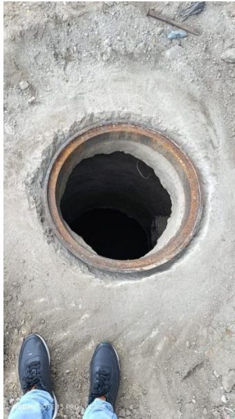
7. Identificación de tapas instaladas en mal estado.
