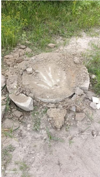
5. Identificación de tapas instaladas en mal estado.
