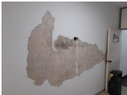
25. Filtraciones y daños en otros espacios arquitectónicos
