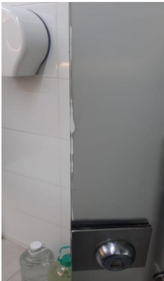
Adhesivos en vinilo deteriorados, sin liquidar el contrato (no presta durabilidad)
