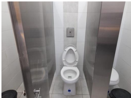
1. Vista aparatos sanitarios y sensor piso 7
