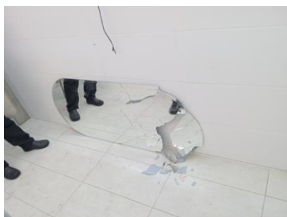
27. Rotura de espejo, sin fijación inferior
