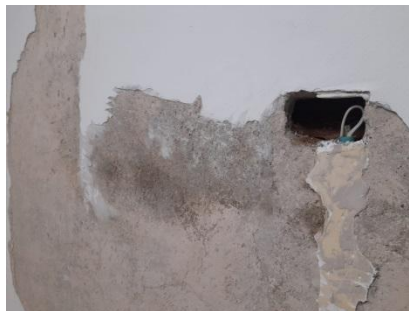
26. Filtraciones en piso 7
