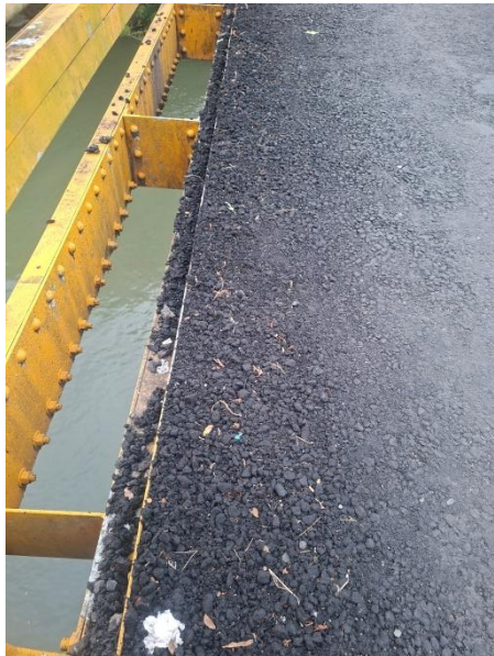
Imagen 20 Acabados observados en los bordes de la capa de rodadura.
