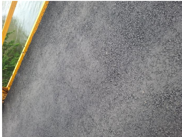
Imagen 19 Sectores donde se evidencian agregados expuestos en la superficie del pavimento.
