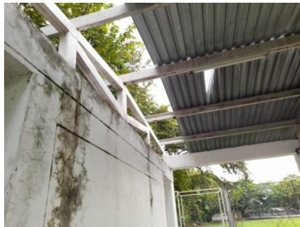
13. Condiciones de deterioro
