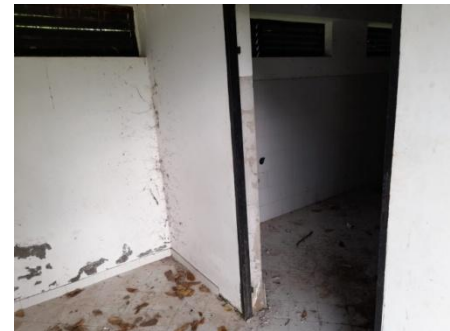
14. Condiciones de vandalismo
