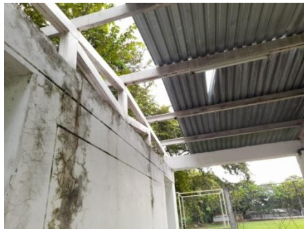
3. Condiciones de deterioro
