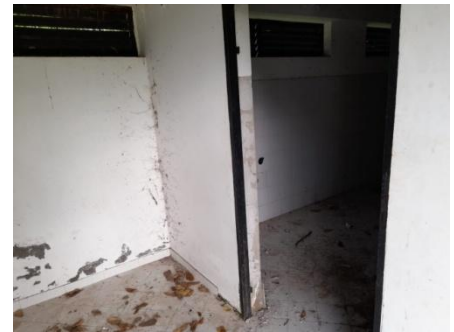
4. Condiciones de vandalismo
