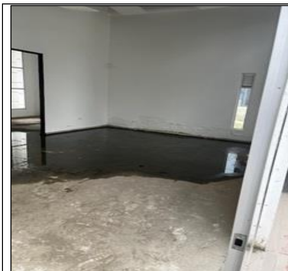
Nivel de afectación de las humedades en el estuco, pintura y marcos de puertas de madera
