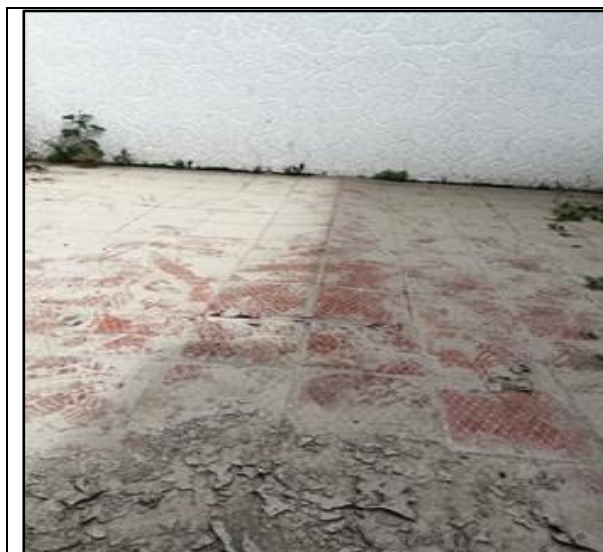
Piso en tableta de gres levantado por deficiencias en el sistema constructivo
