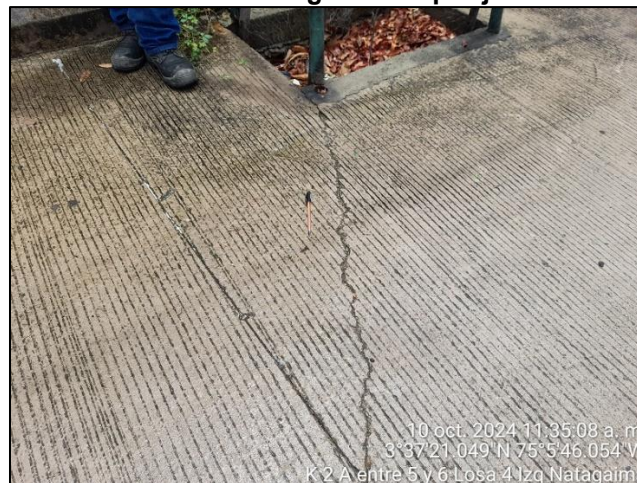
Foto No. 82. Grieta generada por jardinera
