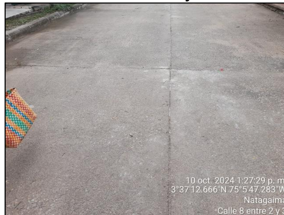
Foto No. 87. Juntas transversal y longitudinal. Deterioro del sello. Calle 8 entre 2 y 3.
