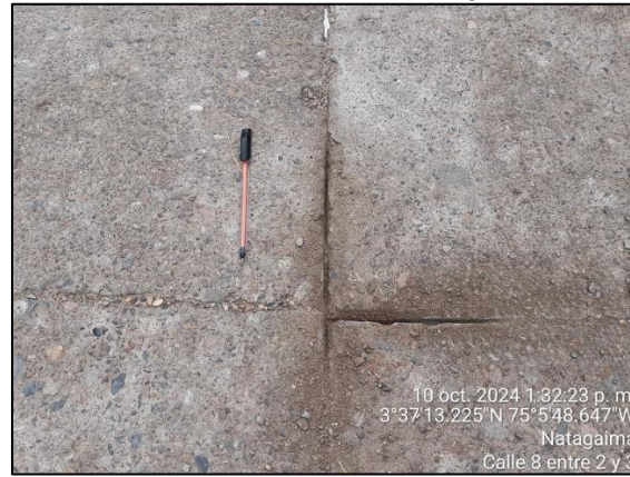
Foto No. 86. Juntas transversal y longitudinal. Deterioro del sello y ausencia de cordón de respaldo.
