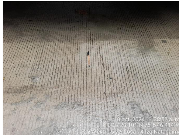
Foto No. 83. Grieta transversal
