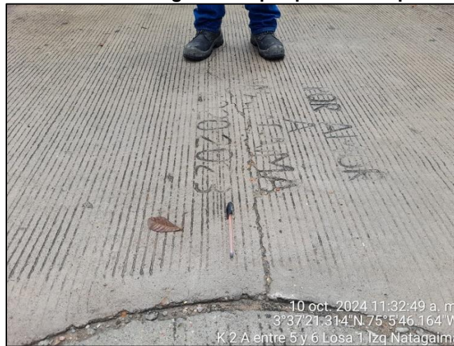
Foto No. 81. Grieta generada por pozo de inspección
