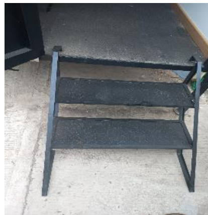
Una de las escalerillas no se puede ajustar quedando inestable. Fuente: Visita in situ – Equipo auditor
