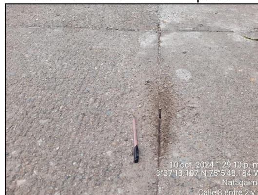
Foto No. 85. Junta transversal. Deterioro del sello y ausencia de cordón de respaldo.
