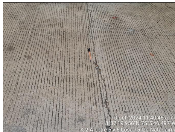
Foto No. 84. Grieta transversal
