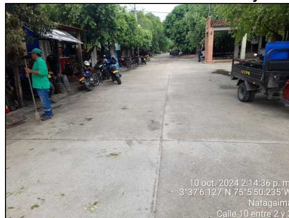
Foto No. 88. Juntas transversal y longitudinal. Deterioro del sello. Calle 10 entre 2 y 3
