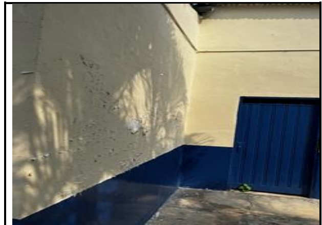
2. Mala calidad en la aplicación de pintura
