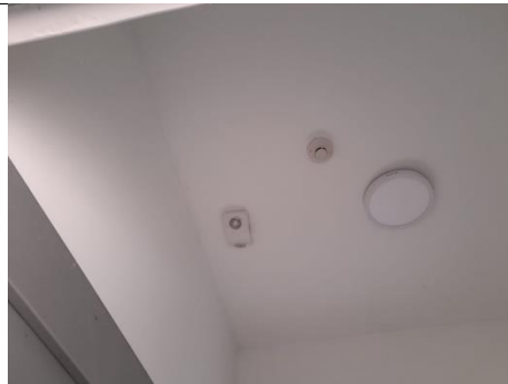
49. Luz de emergencia y sensor contra incendios
