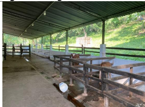
2. Instalaciones en zona de animales
