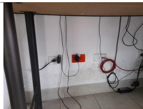
45. Instalaciones de datos y puntos eléctricos
