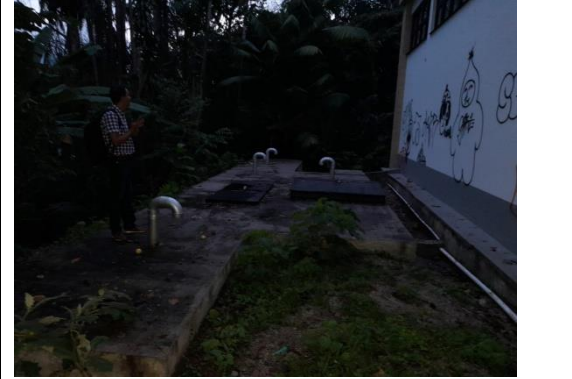
31. Zona de bombas, tanque
