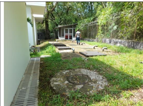
18. Zona de bombas tanques y planta
