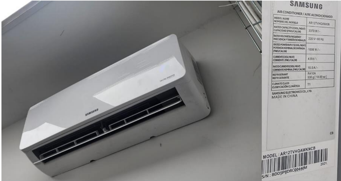
Imagen 13: Aire acondicionado Instalado Cuarto de RACK.
