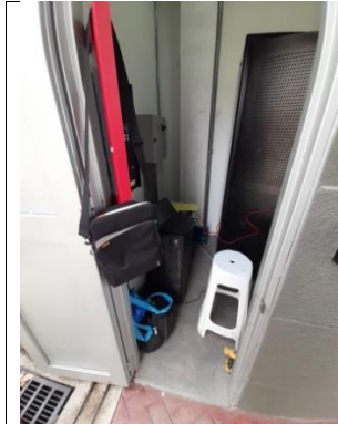
42. Cuarto de comando técnico
