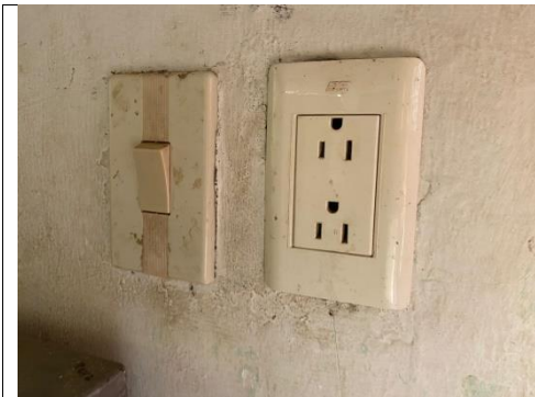
3. Puntos eléctricos instalados
