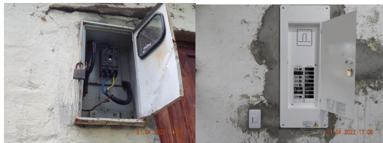
Totalizador y tablero con espacio para totalizador
