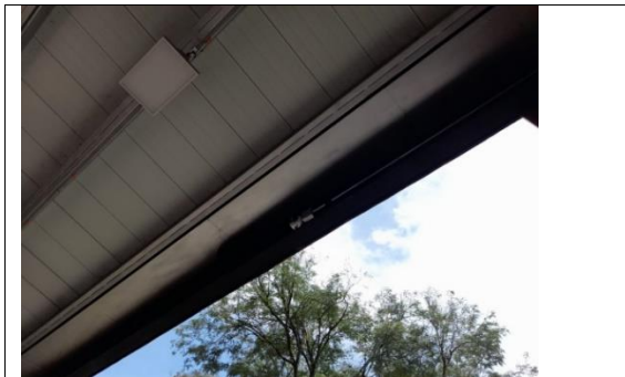
41. Cámaras de vigilancia
