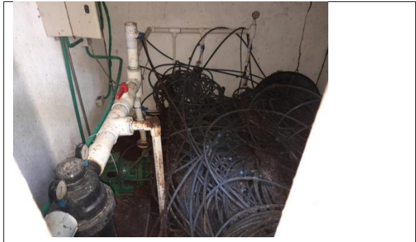
7. Cuarto de bombas
