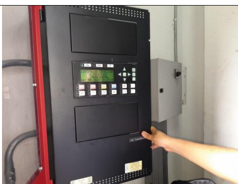
53. Sistema de detección de incendios
