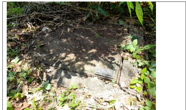
9. Caja eléctrica de inspección
