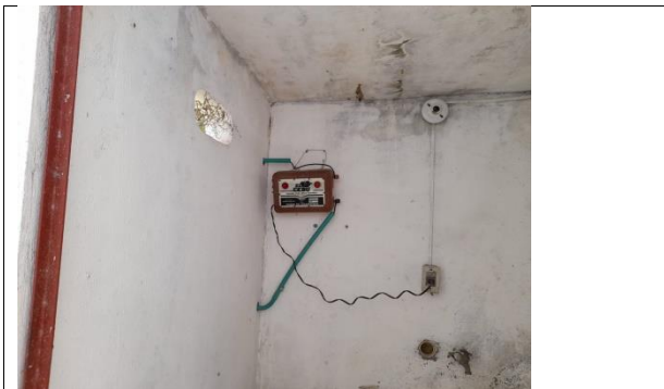
8. Sistema cerca eléctrica
