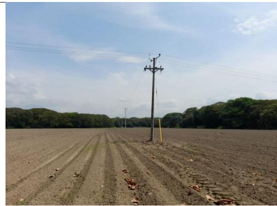
13. Postes y línea de conducción de energía
