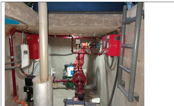
32. Interior de cuarto de máquinas subterráneo
