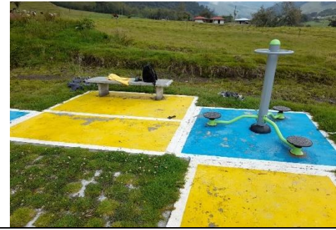
59. Desprendimiento de pintura
