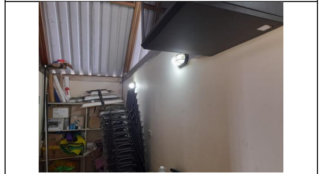
15. Puntos eléctricos interiores
