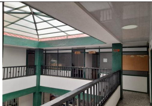
23. Puntos eléctricos hall principal
