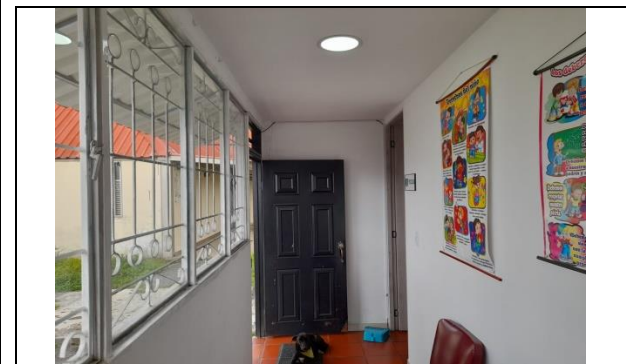
9. Carpintería metálica y vidrios que no cumplen con especificación técnica
