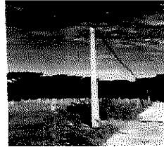
Como se puede observar, la red de baja tensión se encuentra en un 100% de ejecución como se mencionó anteriormente.
