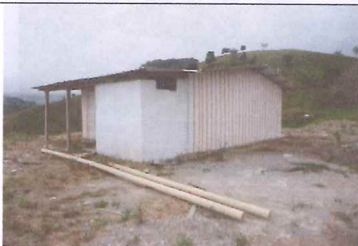
17. Instalaciones hidrosanitarias sin funcionar
