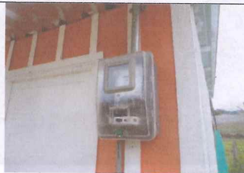
67. Medidor eléctrico instalado
