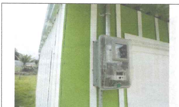
61. Medidor eléctrico funcionando
