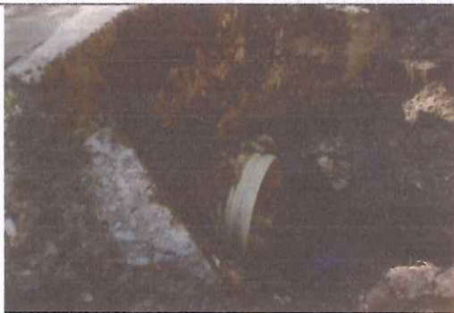
2. Instalación inadecuada. Sin compactación ni sello, etc. generando socavación y servicio nulo
