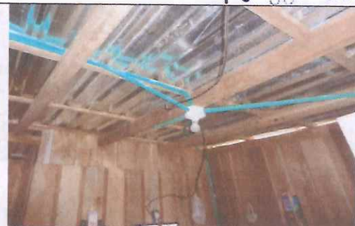
4. Puntos eléctricos, plafón
