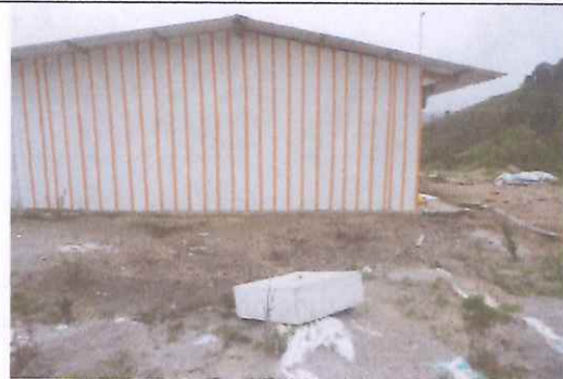
16. Lavadero sin instalar
