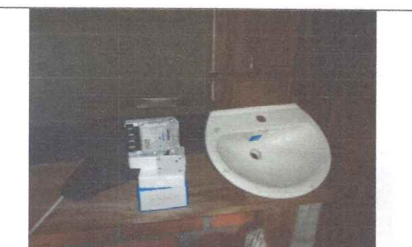
26. Medidor eléctrico y lavamanos sin instalar ni funcionar
