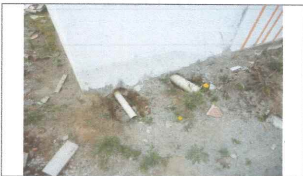
23. Descole sin funcionar, sin conexión
