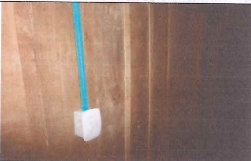
5. Punto eléctrico interruptor, de acuerdo con contrato
