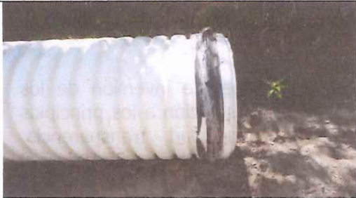
Tubos con alto riesgo de deterioro y daño
