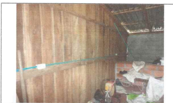
24. Puntos eléctricos que no funcionan
