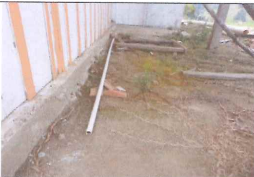
29. Acometida hidráulica sin completar
