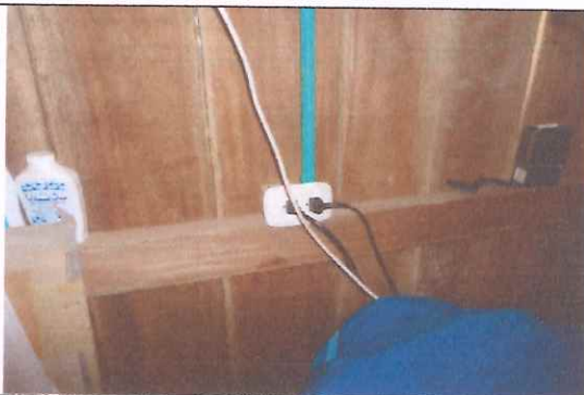
7. Punto eléctrico toma, de acuerdo con contrato
