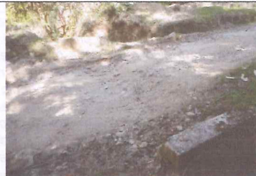
1. Asentamiento en vía por instalación inadecuada del tubo
