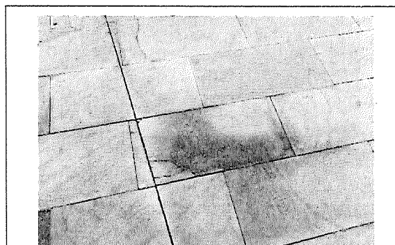
65. Tabletas fracturadas por fallencias en de soporte
