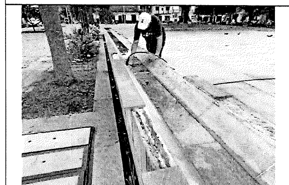
73. desprendimiento de baldosas en antepecho
