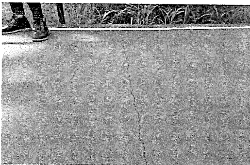
84. manejo inadecuado de dilataciones induciendo al desprendimiento del revestimiento
