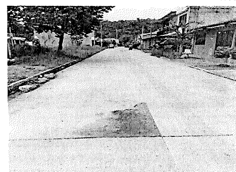
7. proceso constructivo deficiente en algunas placas
