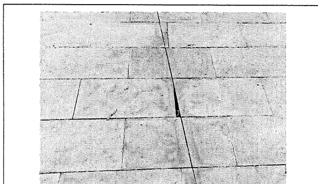
66. Tabletas desprendidas adyacentes a dilataciones
