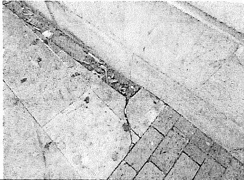
74. piedra muñeca fracturada en zona de confinamiento de adoquín
